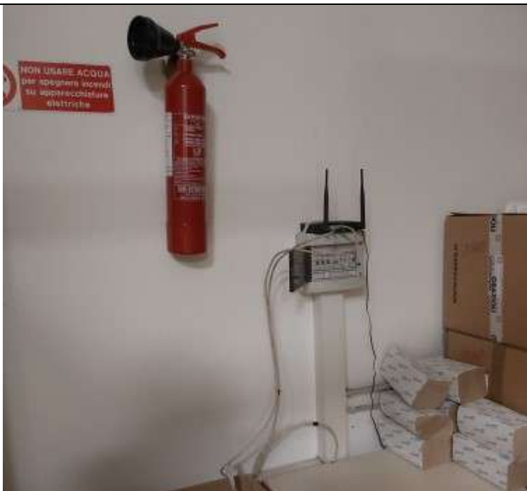
Access Point collocato nel locale 15
